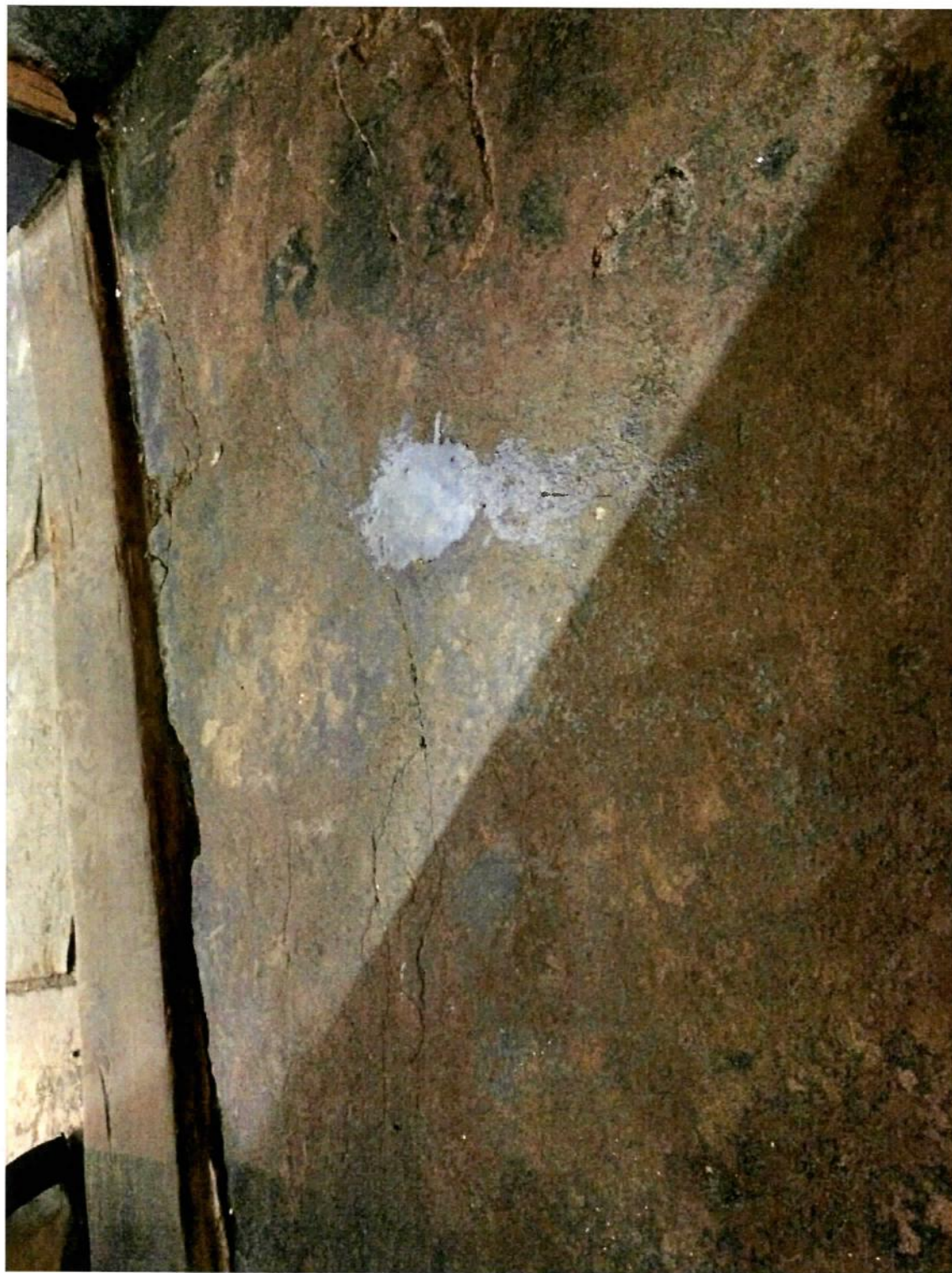
Конденсат воды на бетоном полу.
